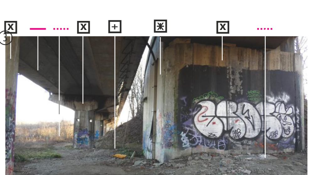
"Degrado" sotto il "terzo ponte", ambiente poco sicuro, presenti molti rifiuti
