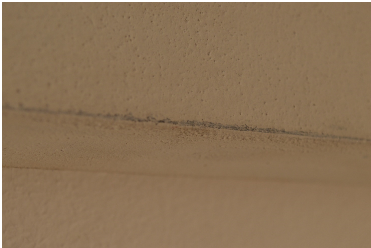
Fig. 52 Abrasione della pellicola pittorica lungo i margini del telaio con esposizione della preparazione nera sottostante.
