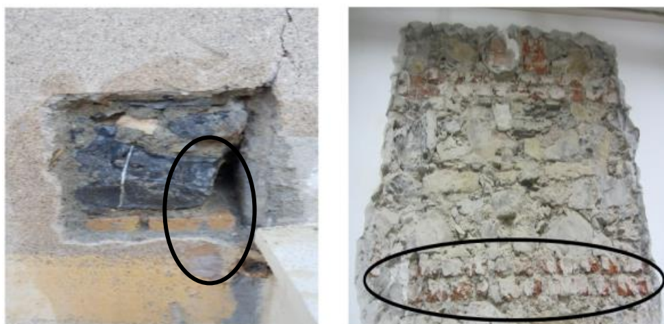
Figura 11: Peeling sulla parete esterna e listature in mattoni nella parete in pietra (da Jamil H.)
