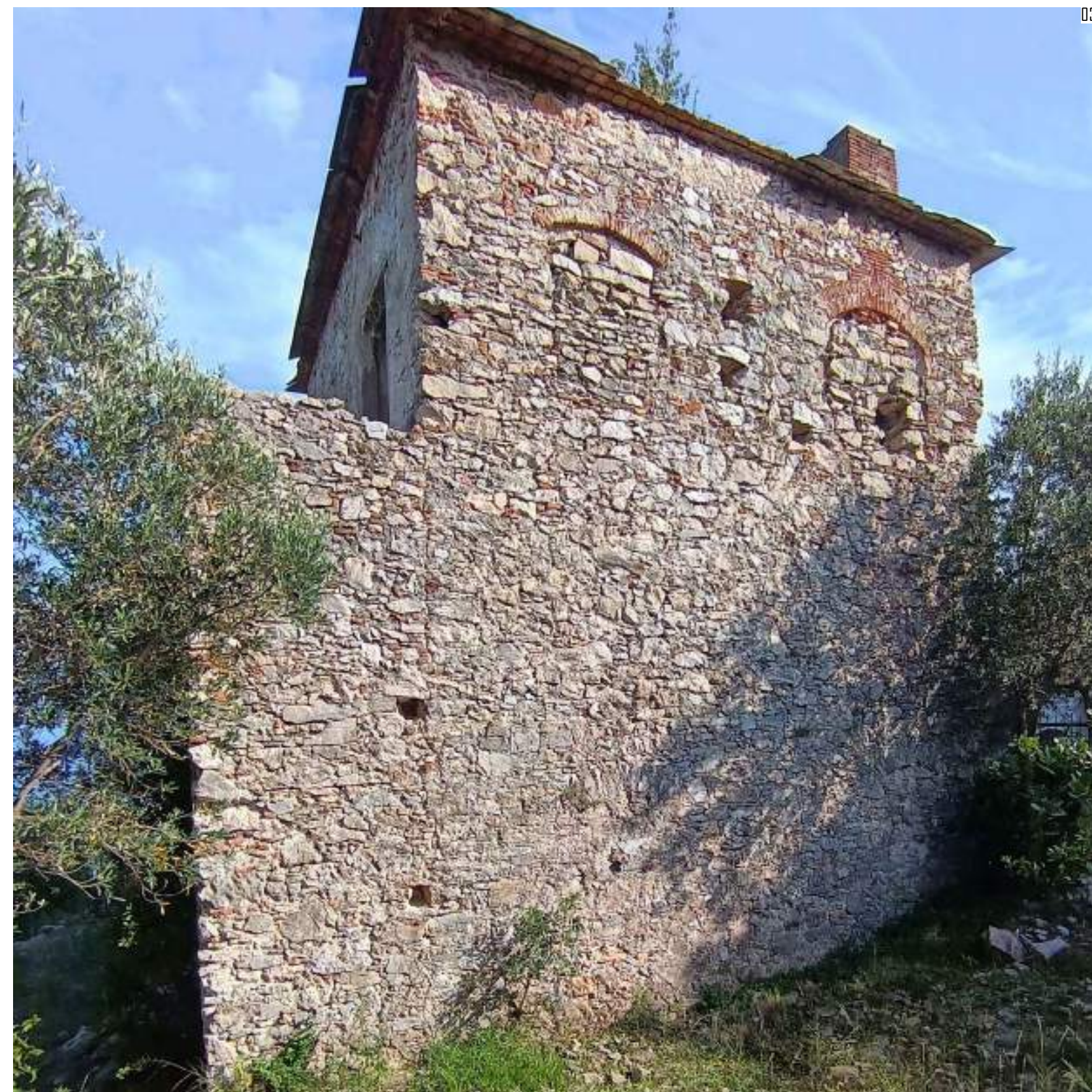
03: Acquisizione fotografica del lato nord del manufatto con vista sulla crepa nel giunto della scatola muraria
