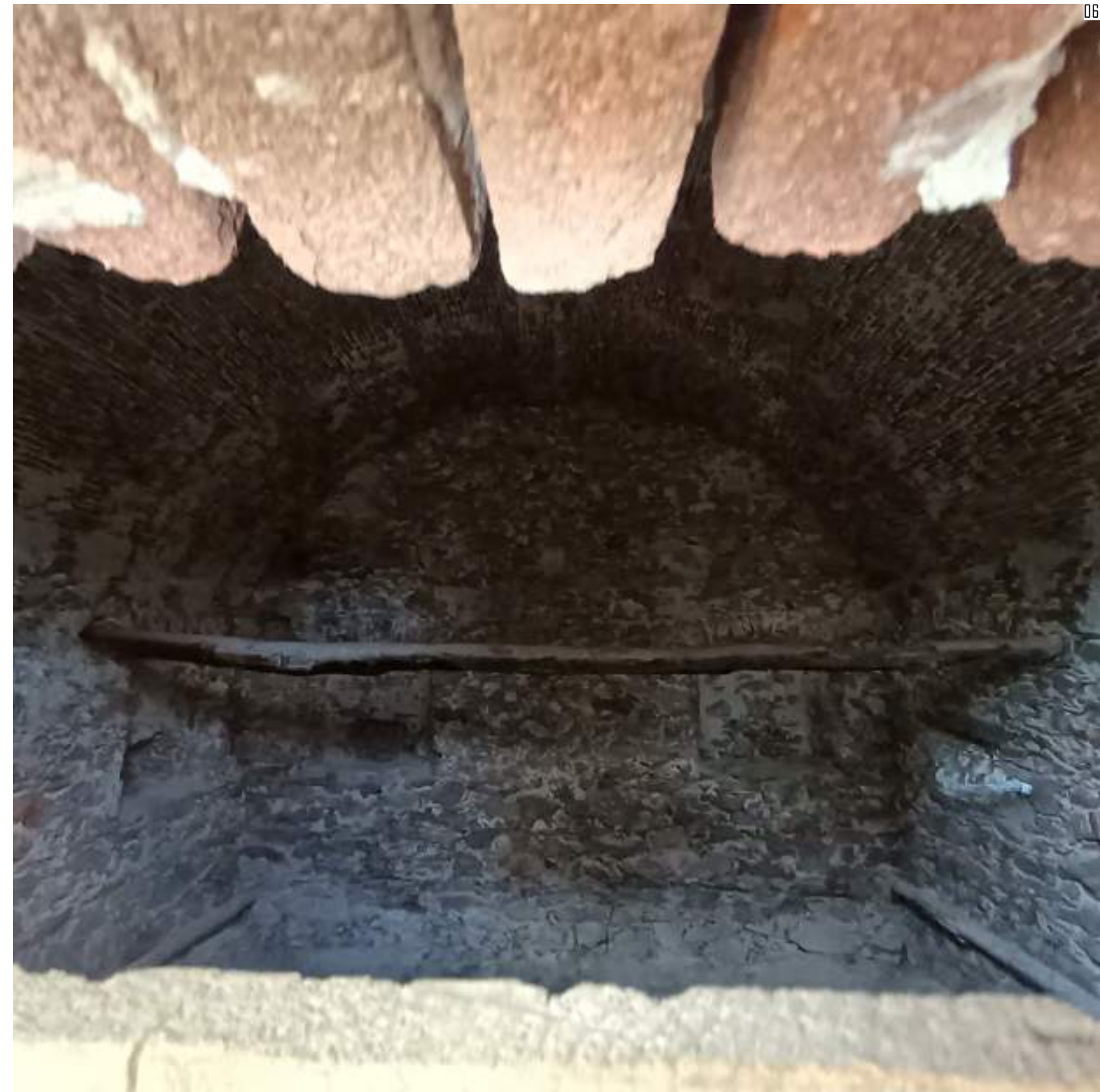
06: Trave marcescente e disgregazione della malta tra gli elementi
