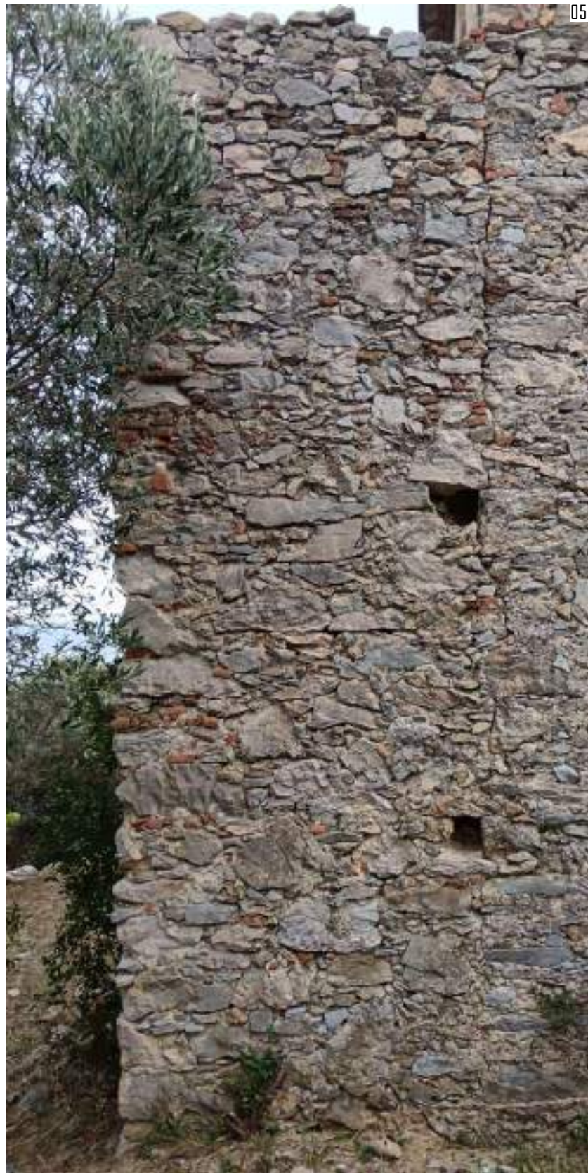
05: Porzione muraria con fessura corrente da terra a cima
