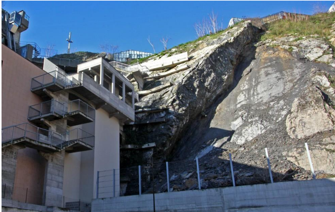
Figure 3. Landslide in Via Digione, Genoa in 1988 (source: https://genova.repubblica.it/cronaca/2014/02/05/foto/via_digione_frana_in_sicurezza_ma_fa_paura_il_ricordo_del_c8-780S2S17/12/?utm_source=chatgpt.com#7 )
