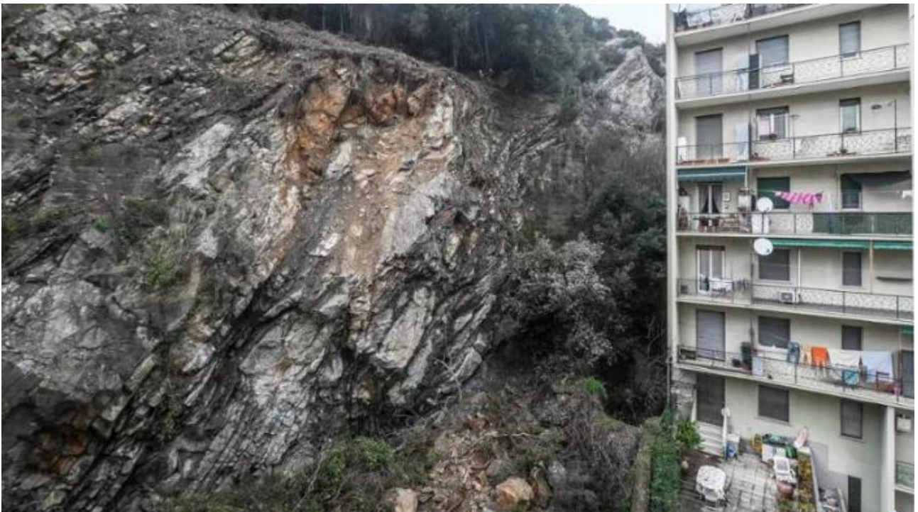
Figura 38: Frana di crollo di via Posalunga a Genova avvenuta il 24 dicembre 2022 (Il Secolo XIX).
