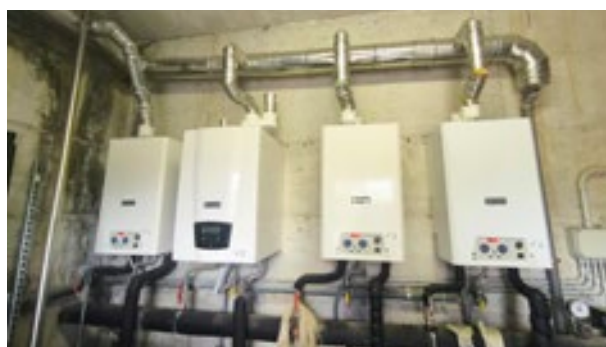
Fig. 6.23 Caldaie in centrale termica.
