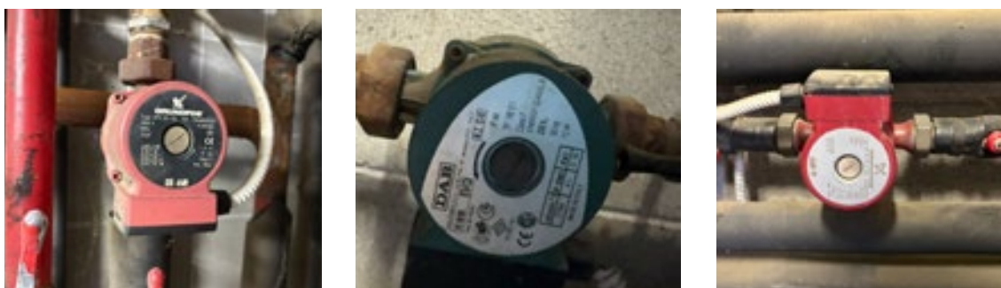
Fig. 6.29 Pompe di circolazione acs: Pompa 3, Pompa 4, Pompa 5.
