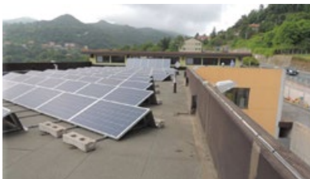
Fig. 6.19 Impianto fotovoltaico e impianto solare termico.
