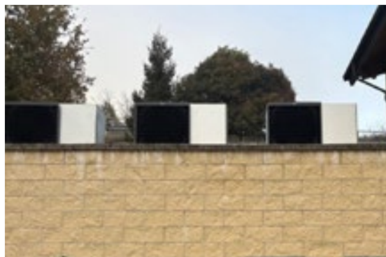
Fig. 7.17 Pompe di calore.
