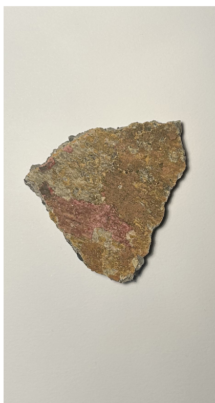
◀ A sinistra: Fotografia del campione di intonaco C03, prelevato nella facciata esposta a Sud relativo alla cornice del portone di accesso.
