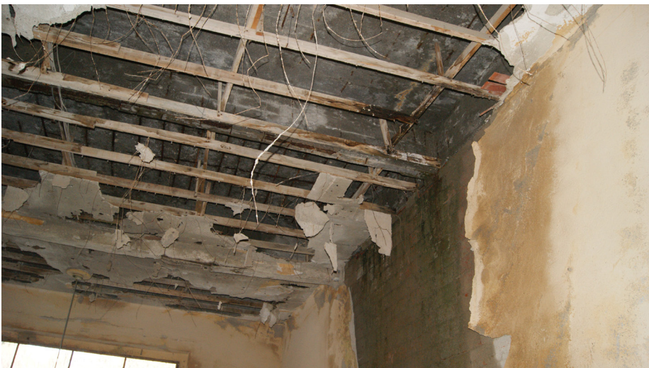
◀ Infiltrazione d'acqua dal tetto che ha provocato la corrosione delle barre nel calcestruzzo e la successiva rottura del copriferro, e la caduta del controsoffitto.
