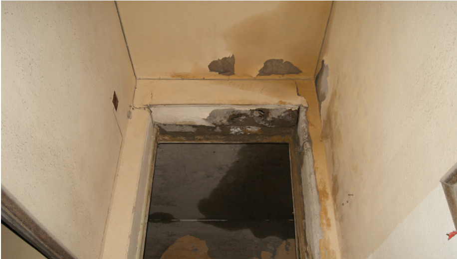
◀ Infiltrazione d'acqua piovana al piano terra, dal piano superiore.
