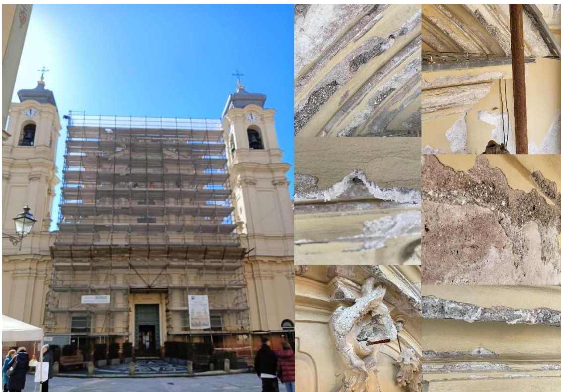
Fig.1.1. Elaborazione di fotografie realizzate dalla restauratrice Dott.ssa Eleonora Parravicini e durante i rilevamenti di cantiere. Sono in evidenza i distacchi parziali e totali di colore, finiture, elementi decorativi. Sono inoltre visibili gli effetti della cristallizzazione salina.
