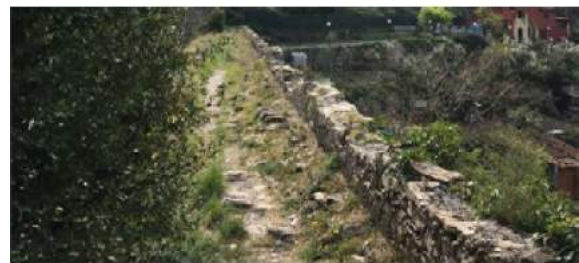
C. Sentiero su Ponte Ronco del 1600 dissestato
