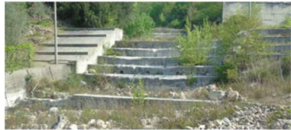
b. Briglia in calcestruzzo armato degradato
