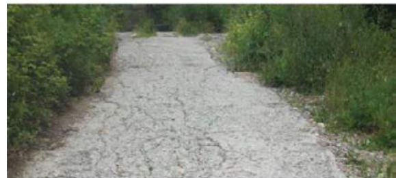
B. Strada pubblica asfaltata danneggiata
