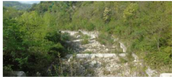
a. Briglie e muri di sostegno degradati
